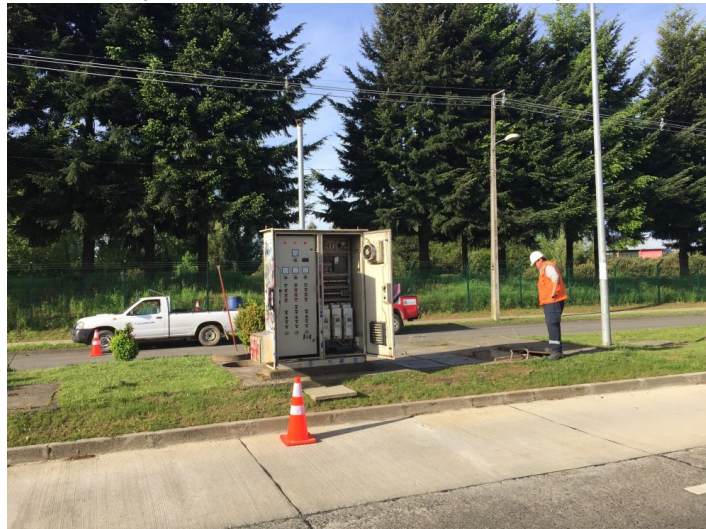
Figura No 2 Inspección Tablero Eléctrico PEAS Simpson
